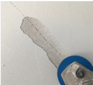
Vết nứt trên tường ALC
