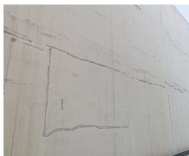
Vết nứt tường ngoài nhà
