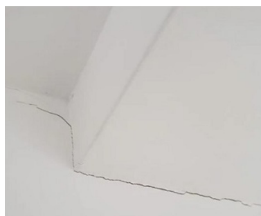
Vết nứt tại góc trần
