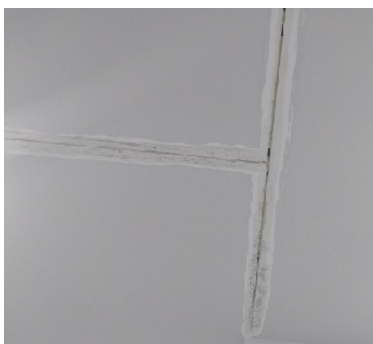
Vết nứt mối nối trần Cemboard
