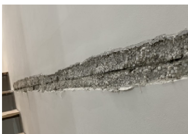
Vết nứt trên tường bê tông EPS
