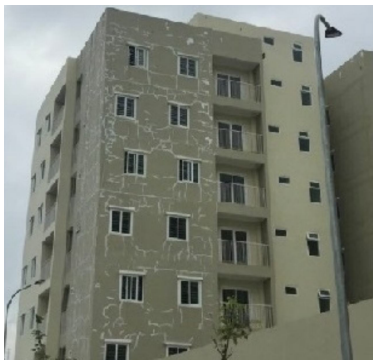
Vết nứt tường ngoài nhà
