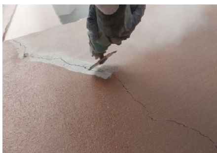
Vết nứt mối nối giữa vật liệu xây dựng lắp ghép
